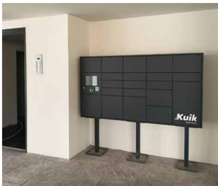
Instalación en exterior cubierto
